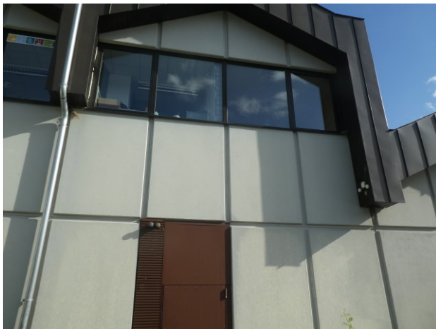
Abb. 3: Nester in der Nordfassade des großen Gebäudes.
